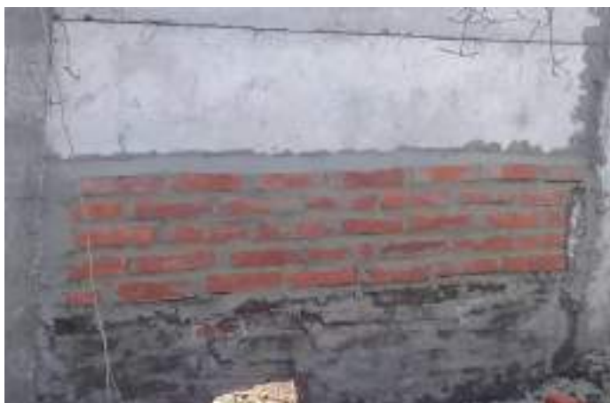
Foto 27 y 28. Arreglo de paredón, según la Junta Vecinal, fue dañado por personas que viven fuera del barrio para ingresar por ese sector. Fuente: Portal de Facebook de Junta Vecinal Altos de Podestá.
